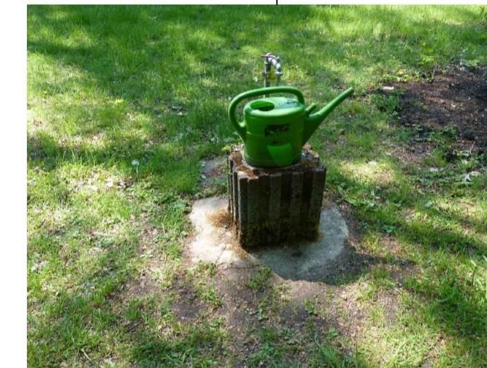
Beispiel neue Wasserentnahmestelle Waldfriedhof Saarbrücken Burbach
